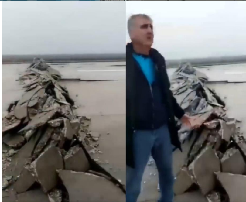
شکل (۱۸): ترک خوردگی شدید در باند فرودگاه هاتای ترکیه (HTY) در این زلزله
